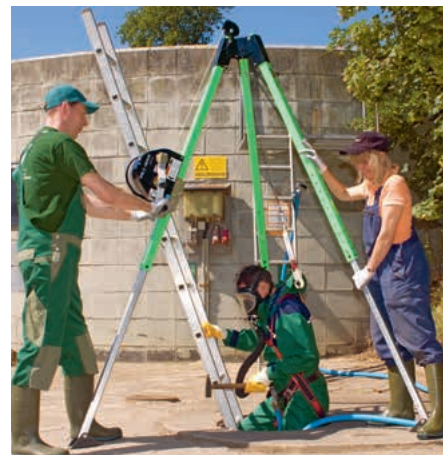
Einstieg ins Güllelager am Rettungsgurt mit einem umluftunabhängigen Frischluftgerät – gesichert durch zwei Personen.
